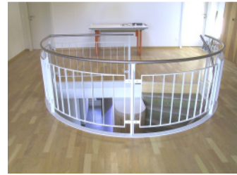
Geländer und CNS Handlauf Schüpheim
